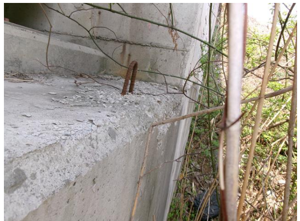
궁촌1교 상행선 교대 A2 구체 측면 콘크리트 박리 0.3*0.6
