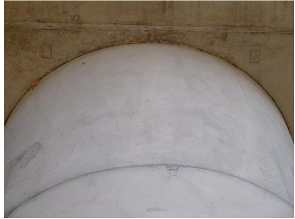
궁촌1교 상행선 교각 P1 기둥부 좌측면 수직균열 0.2/1.2
