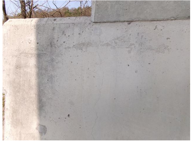
궁촌1교 상행선 교대 A2 구체 수직균열 0.2/0.6
