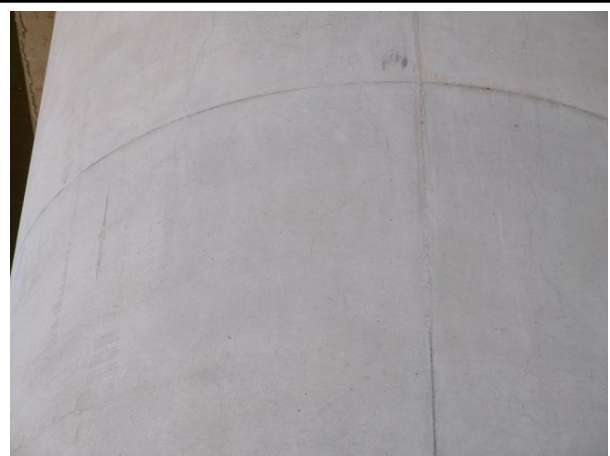
궁촌1교 상행선 교각 P1 기둥부 정면 수직균열 0.2/2.5
