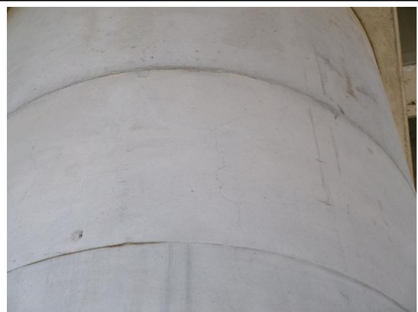
궁촌1교 상행선 교각 P1 기둥부 우측면 수직균열 0.2/2.5
