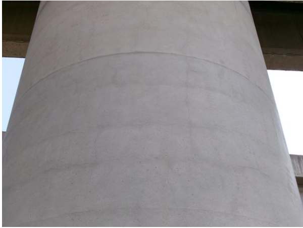
궁촌1교 상행선 교각 P1 기둥부 좌측면 망상균열 4.5*1.5 CW=0.2
