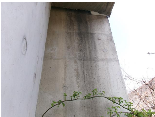
궁촌1교 상행선 교대 A2 흙벽 누수흔적 0.3*2.0
