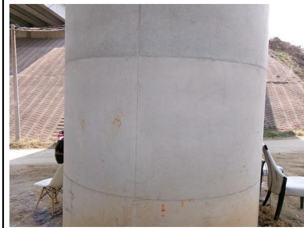
궁촌1교 상행선 교각 P1 기둥부 배면 망상균열 2.5*1.5 CW=0.2
