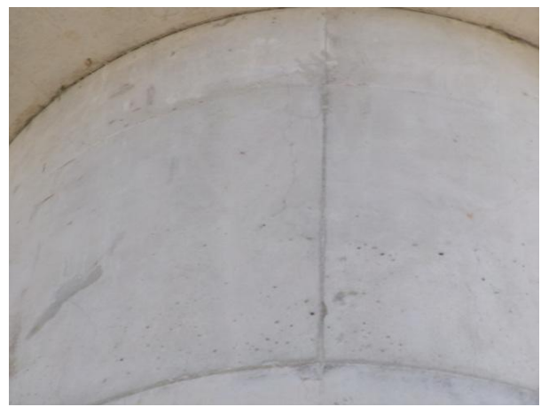
궁촌1교 상행선 교각 P1 기둥부 배면 수직균열 0.2/1.2
