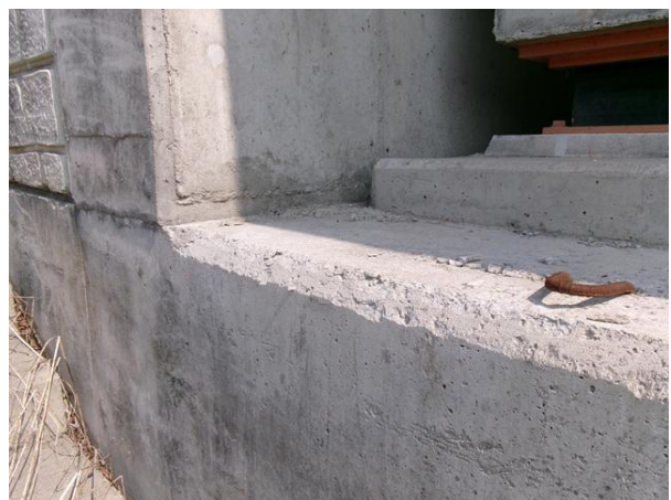
궁촌1교 상행선 교대 A2 구체 상면 콘크리트 박리 0.1*0.5
