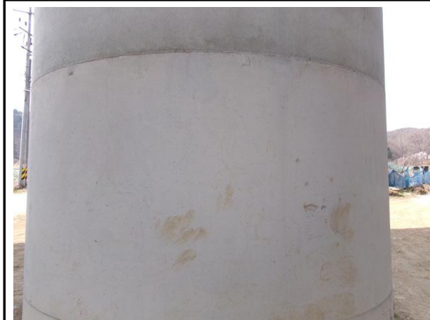
궁촌1교 상행선 교각 P1 기둥부 우측면 망상균열 4.5*1.5 CW=0.2
