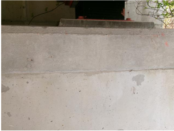
궁촌1교 상행선 교대 A2 구체 수직균열 0.2/0.3
