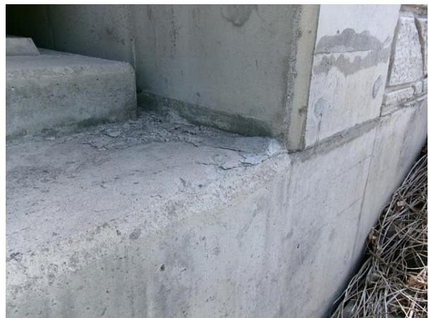
궁촌1교 상행선 교대 A1 구체 상면 콘크리트 박리 0.2*0.3
