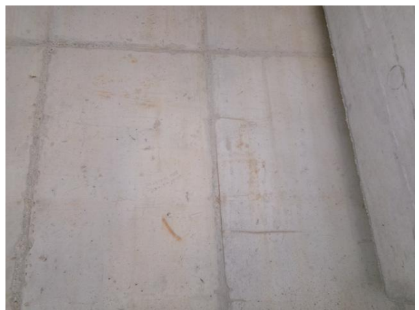
궁촌1교 상행선 교대 A2 흙벽 수직균열 0.2/2.0
