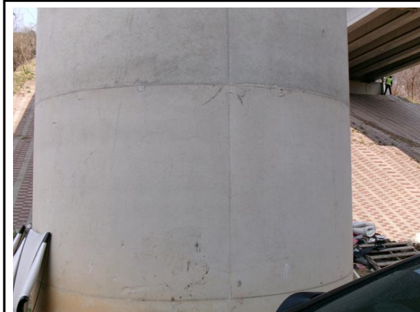
궁촌1교 상행선 교각 P1 기둥부 정면 망상균열 2.5*1.5 CW=0.2
